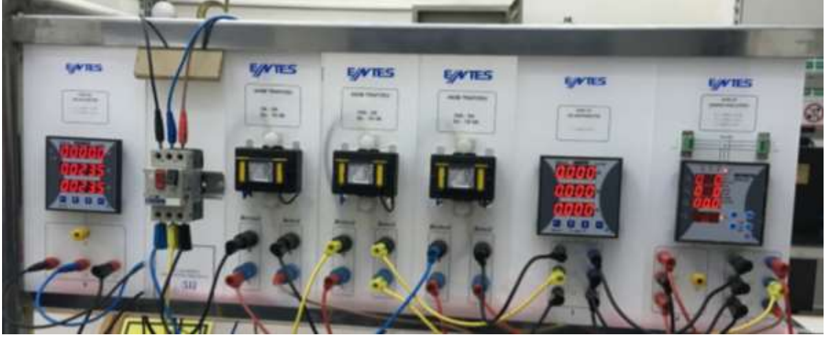
Şekil 5.3 : Motora giden akım ve voltajın ölçümü için kurulan devre.
